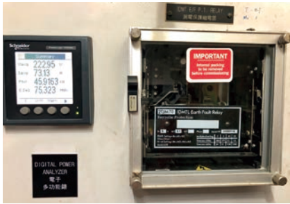
渣華道108號商業中心的電力功率分析儀
